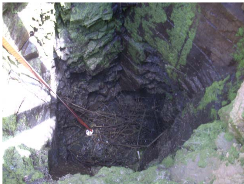
Figura 11. Palos y escombros a una profundidad de 7 m.
