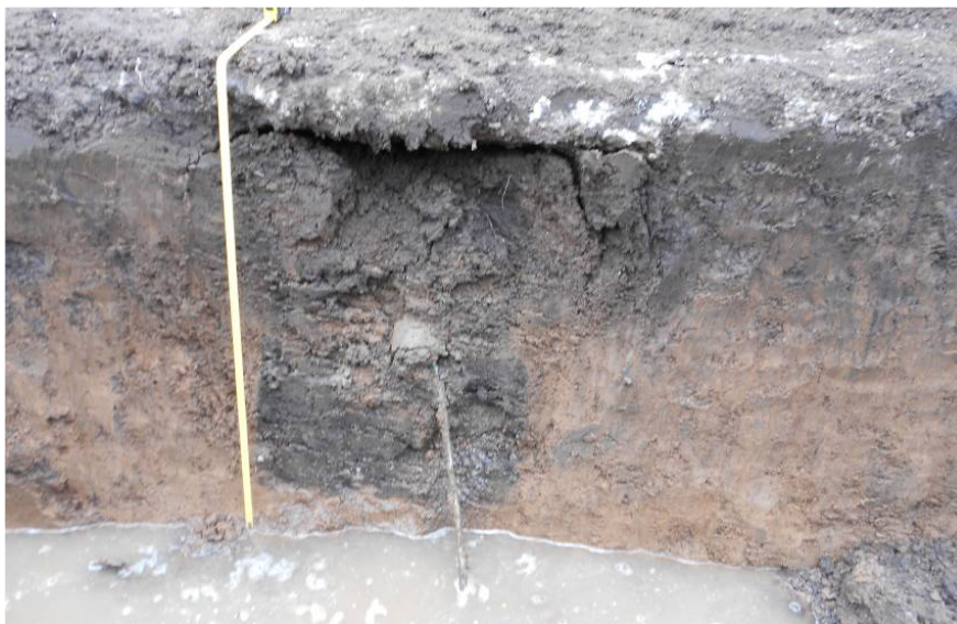
Figura 20. Trinchera por debajo de la zapata que rodea la casilla, en la que se aprecia la presencia de una fosa destinada a alojar un ducto contenedor de cables subterráneos
