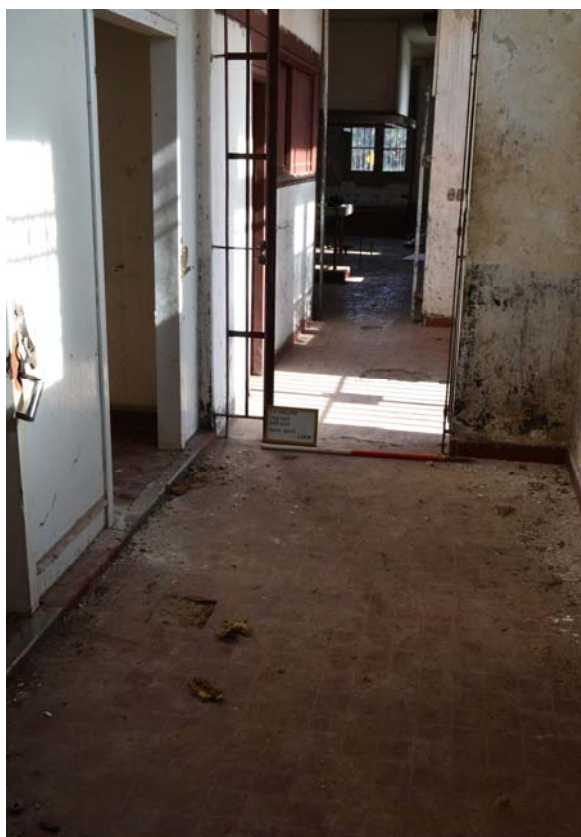
Figura 7. Vista general del área Cocina (Sector Cocina al fondo y Sector Pasillo en primer plano).
