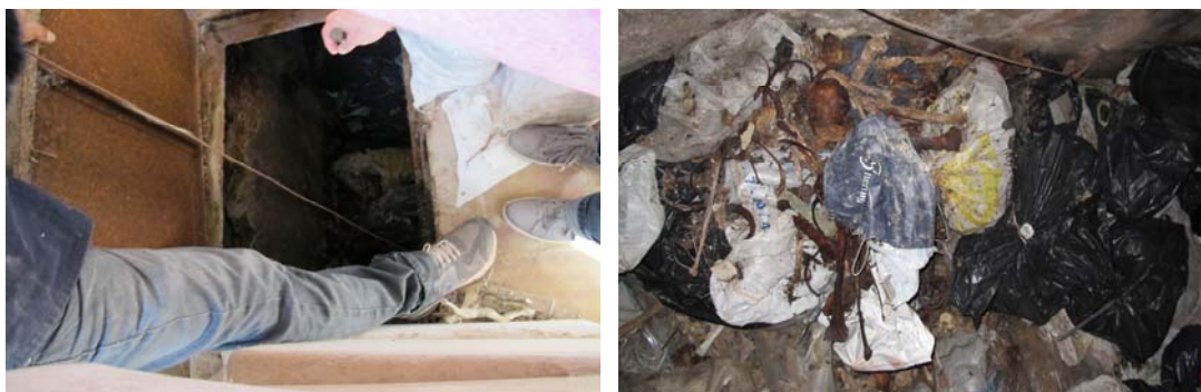
Figura 6. Izq. Acceso al osario; Der. Estado en el que se encuentran las bosas dentro del osario.
