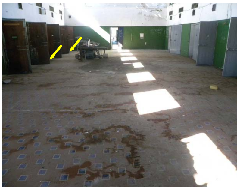
Figura 5. Vista del Pabellón A desde el Norte. Se indican zonas señaladas por testigo.
