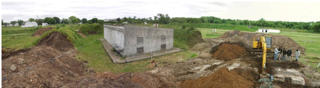
Figura 5. Zona Polvorín con vista panorámica de estructura edilicia y terraplén de contención en proceso de excavación.
